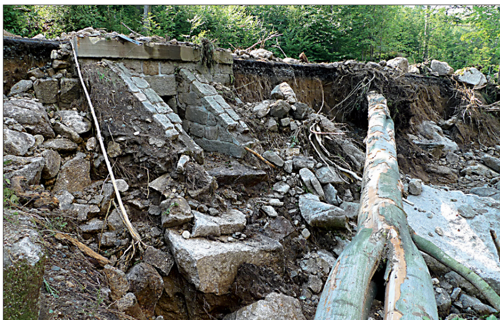
Obr. 11. Na opačné straně silnice murová eroze (mura 2) zcela odnesla její násep a vytvořila pod asfaltovou vozovkou až 3 m vysoký, svislý stupeň.
